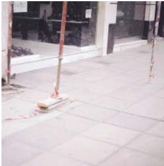
Απαράδεκτη έδραση σκαλωσιάς (δύο ορθοστάτες αριστερά). Ορθή έδραση (ορθοστάτης δεξιά).
