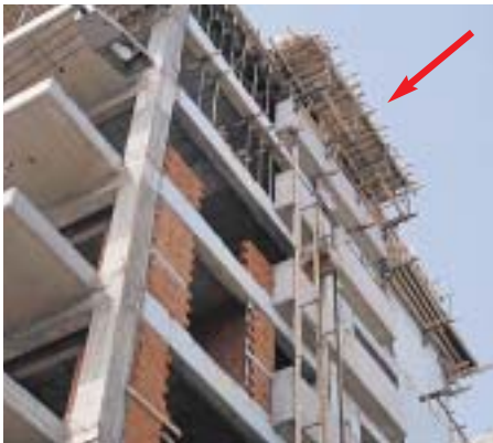
Σκαλωσιές εξωτερικών τοιχείων χωρίς προστασία έναντι πτώσης.
