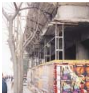
◀ Περίφραξη εργοταξίου με άδεια κατάληψης πεζοδρομίου. Προστατευτικό προστέγασμα. Απαιτείται συμπλήρωσή του στο γωνιακό τμήμα.
