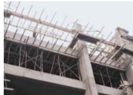
Δάπεδα εργασίας ασφαλή στο σχεδιασμό τους. Απαιτείται: • Συμπλήρωση στην προστασία έναντι πτώσης. • Αντικατάσταση των πηλακάζ με μαδέρια.
