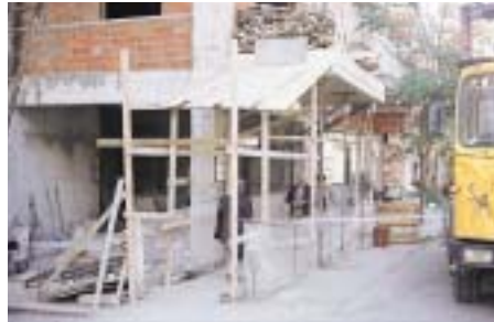
Προστατευτικό προστέγασμα με ακατάλληλη - επικίνδυνη κλίση.
