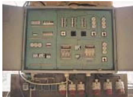
Δεν ξεχνάμε τον αντιηλεκτροπληξιακό διακόπτη (συνδεδεμένο με όλες τις παροχές) και την καθημερινή δοκιμή της καλής λειτουργίας του.
