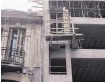
Ασφαλές διπλό πλατάκι (τρυπόξυλο) αριστερά. Δάπεδο εργασίας προστατευμένο μερικώς έναντι πτώσης. Ασφαφέστερα τα μαδέρια αντί πηλακάζ.
