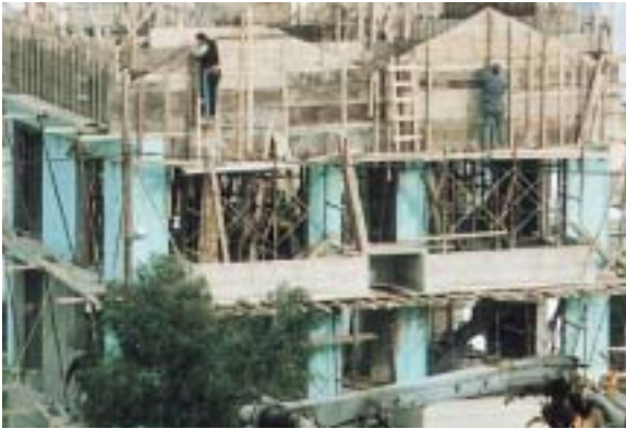
▲ Ανασφαλής χρήση φορτιής σκάλας σε εξωτερικό δάπεδο εργασίας, απροστατευτο έναντι πτώσης.
