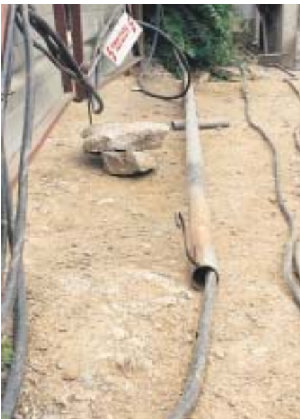
Προστασία καλωδίων από μηχανική φθορά.
