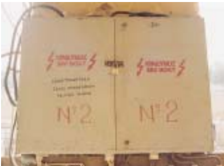
Ηλεκτρικός πίνακας με δυνατότητα επέμβασης μόνο από υπεύθυνο άτομο.
