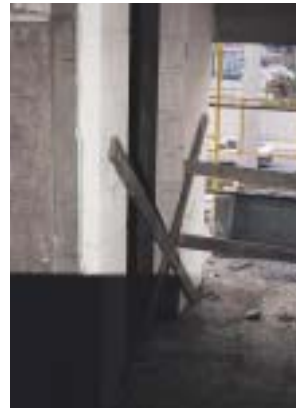
Απαράδεκτη προστασία ανοίγματος ανεγκυστήρα.
