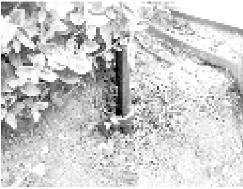
Ράβδος γείωσης στο έδαφος
