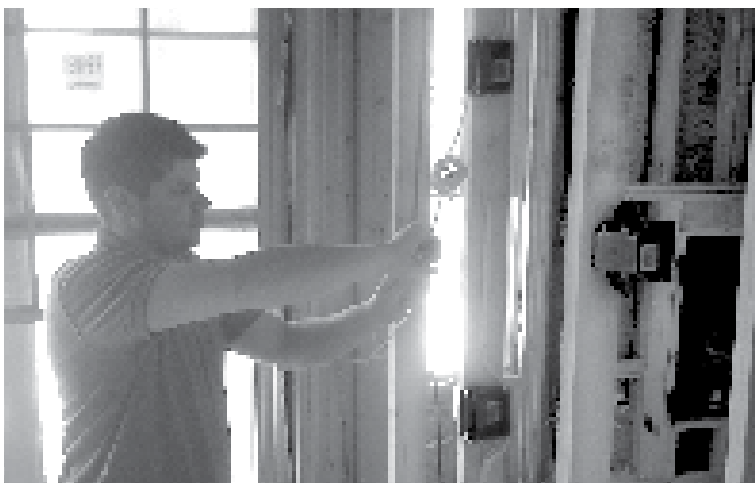
Μη μεταλλικά κανάλια προστατεύουν τα καλώδια από φθορές.
