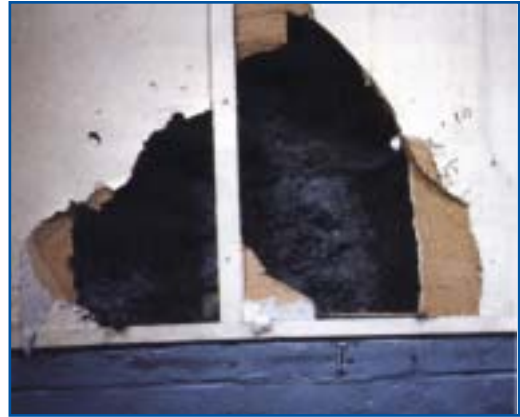
Εξωτερική επένδυση τοίχου που φέρει επικάλυψη από ψεκασμένο κροκιδόλιθο για θερμική μόνωση. Η ψεκασμένη επιφάνεια είναι εγκλωβισμένη πίσω από ένα μη αμιαντούχο χαρτόνι
