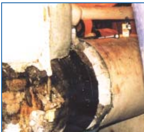
Υψηλής πίεσης σωλήνες μεταφοράς ατμού σε ένα σταθμό παραγωγής ηλε- κτρικής ενέργειας με ένα "Bulldog" τελεί- ωμα πάνω από block μόνωσης "Carosil"
