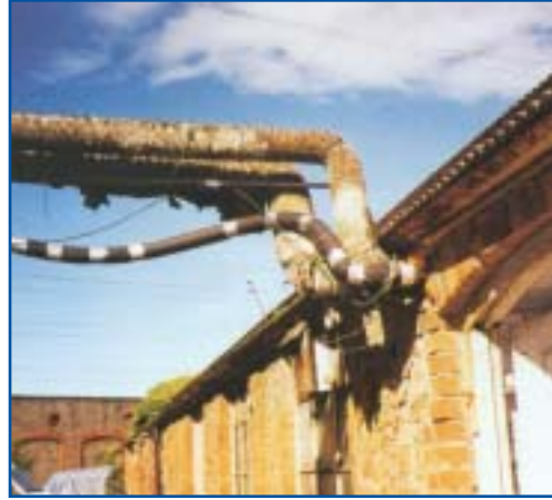
Σωλήνες με μόνωση από αμίαντο σε ένα εργοστάσιο
