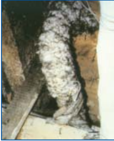
Σωλήνας με μόνωση από αμιαντόσχοινο
