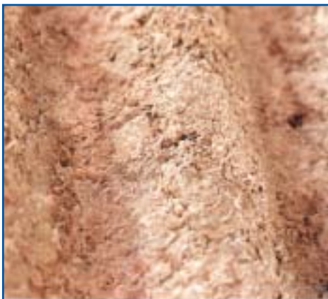
Κοντινό πλάνο επιφάνειας ψεκασμένης με αμοσίτη για μόνωση, κάτω από μία στέγη από αμιαντοτσιμέντο
