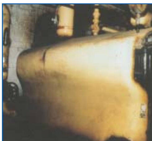
Λέβητας που φέρει μόνωση από αμίαντο καλυμμένος με ένα σκληρό επίχρισμα
