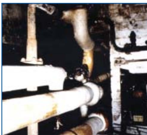
Σωληνώσεις κεντρικής θέρμανσης με μόνωση από αμίαντο
