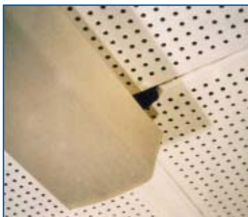
Ταβάνι από βαμμένες ενισχυμένες αμιαντόπλακες με μια μικρή κατεστραμμένη περιοχή από εργασίες για τοποθέτηση φωτισμού
