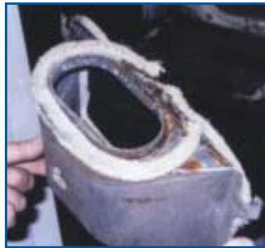
Αμιαντούχο σχοινί για στεγανοποίηση σε ένα οικιακό λέβητα
