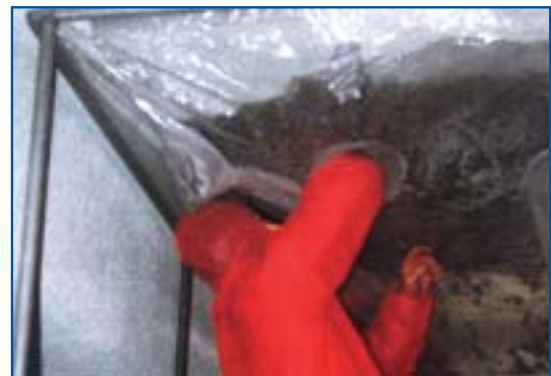
Αφαίρεση ψεκασμένης με αμιάντο επικάλυψης, με τη βοήθεια ειδικού σάκου με γάντια
